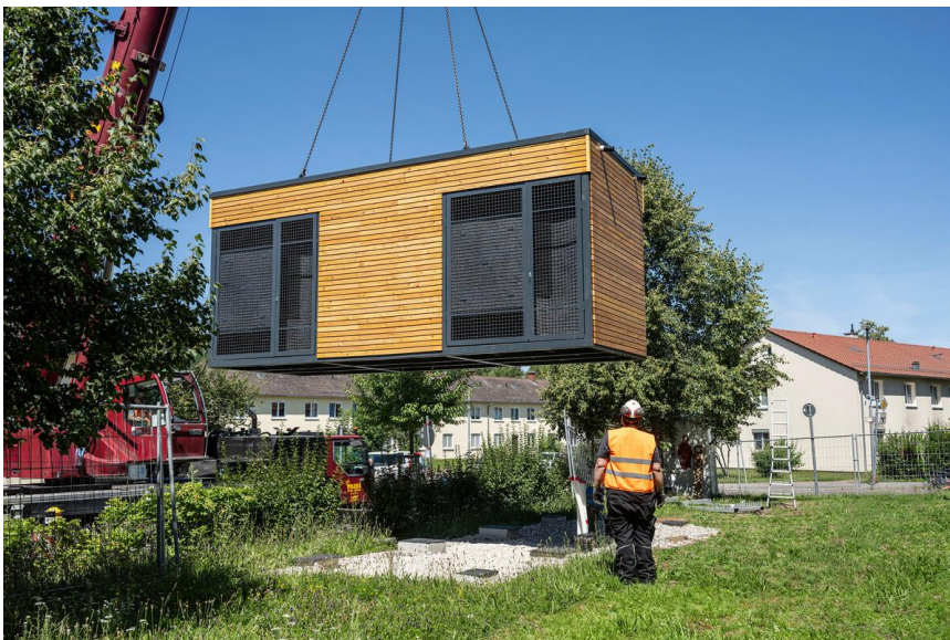
Die neue Energiezentrale am Hausenring beherbergt vier Luft-Wasser-Wärmepumpen. Foto: DAIKIN.
