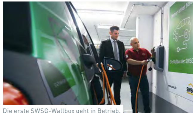
Die erste SWSG-Wallbox geht in Betrieb.
