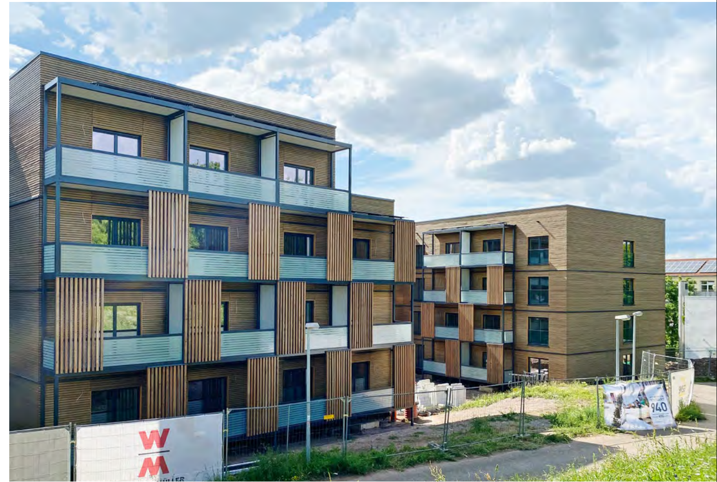
Nachhaltig: Im Prießnitzweg entsteht ein Energie-Plus-Quartier für rund 400 Mitarbeiter*innen des Klinikums Stuttgart.
